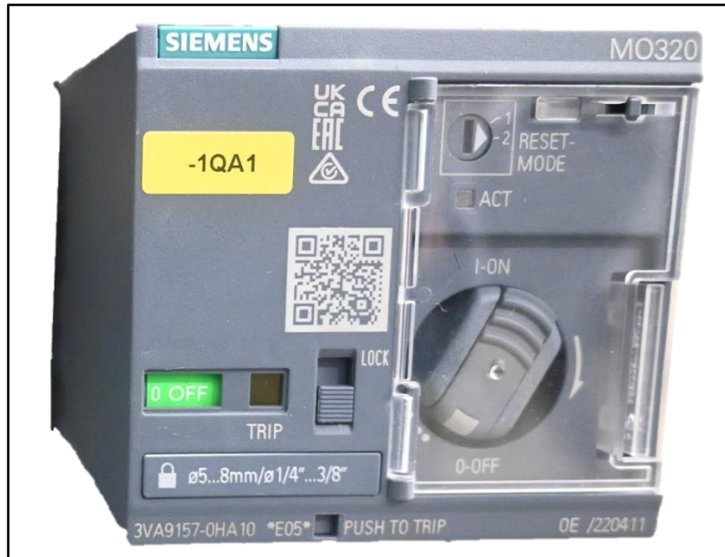
Abb. 13 Leistungsschalter 1QA1 im ControlShield rechts vorn
