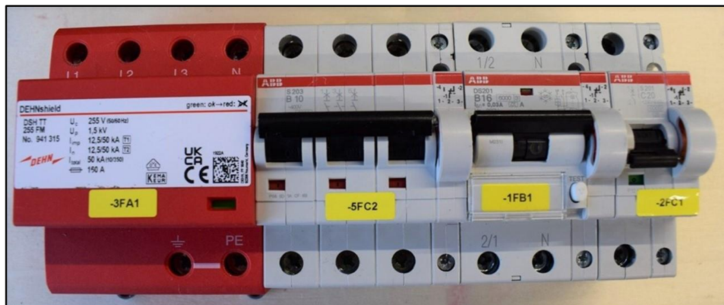
Abb. 14 Blitzschutz und Leitungsschutzschalter im ControlShield hinten Mitte
